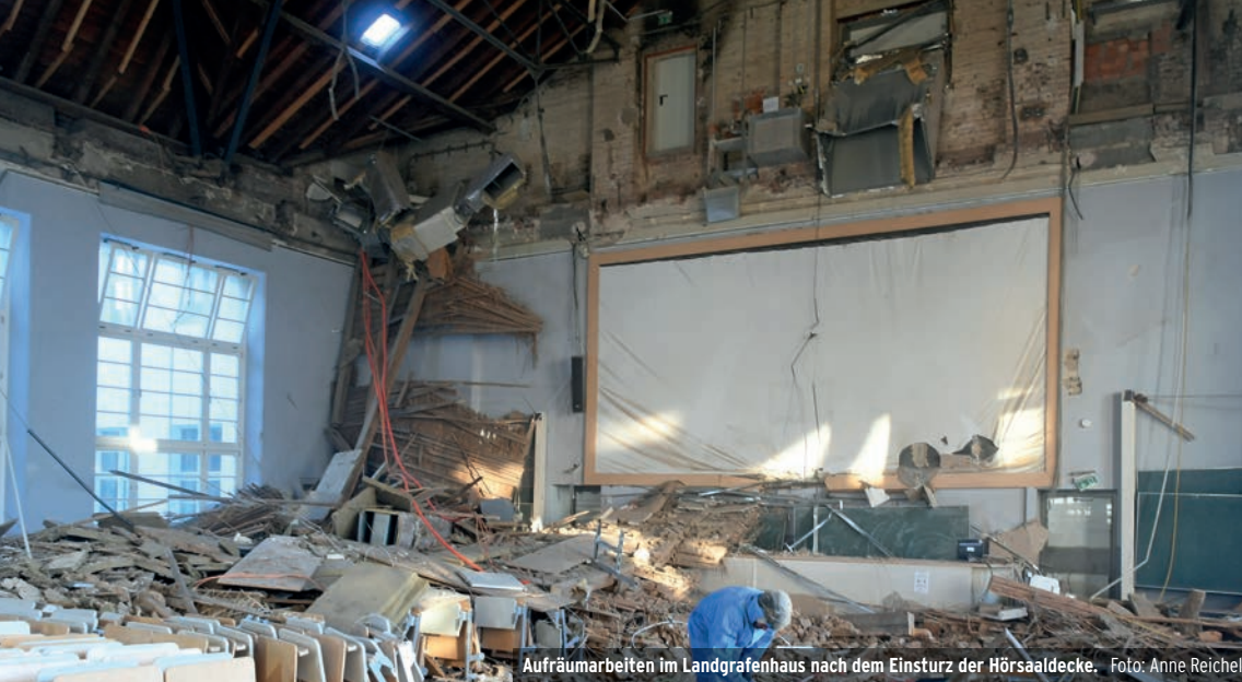
Aufräumarbeiten im Landgrafenhaus nach dem Einsturz der Hörsaaldecke. Foto: Anne Reichel
